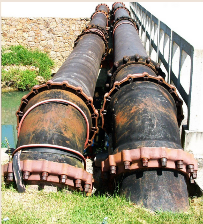
Tubulações de esgoto
