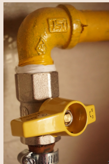
Tubulações e registro para abastecimento de água
