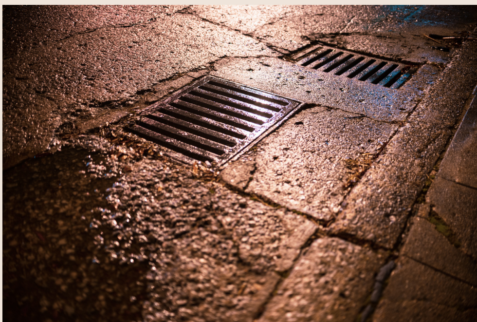
Boca de lobo para drenagem urbana
