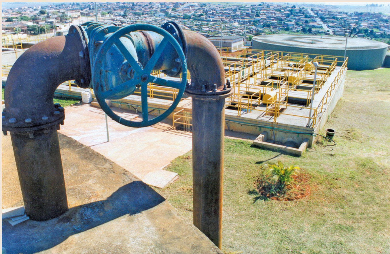
Estação de tratamento de água
