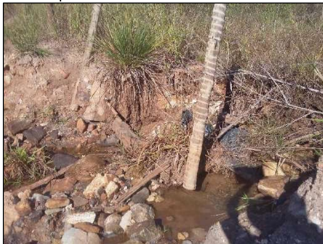
Foto 186: Erosão na margem do rio em drenagem não disciplinada
