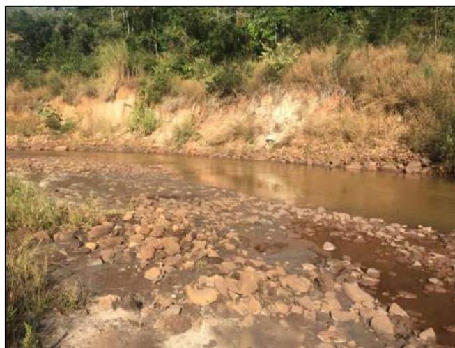
Foto 169: Processo erosivos no talude
