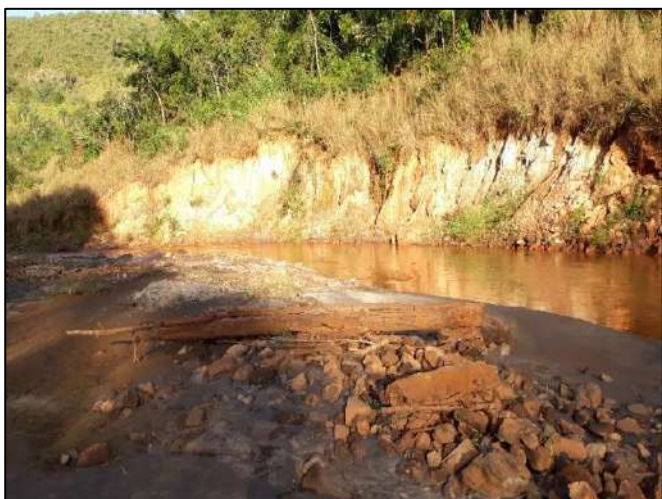
Foto 168: Processo erosivos no talude
