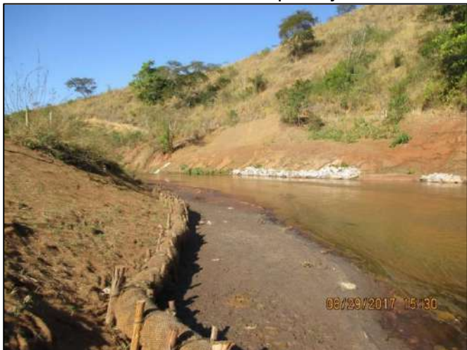
Foto 110: Retentor recoberto por rejeito
