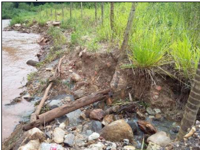
Foto 185: Erosão na margem do rio em drenagem não disciplinada
