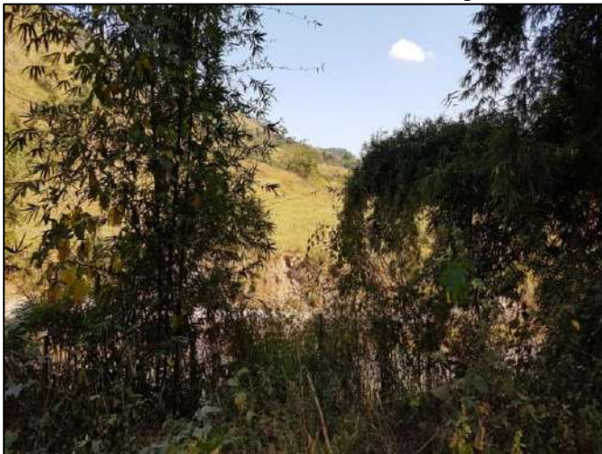
Foto 58: Talude erodido na margem direita
