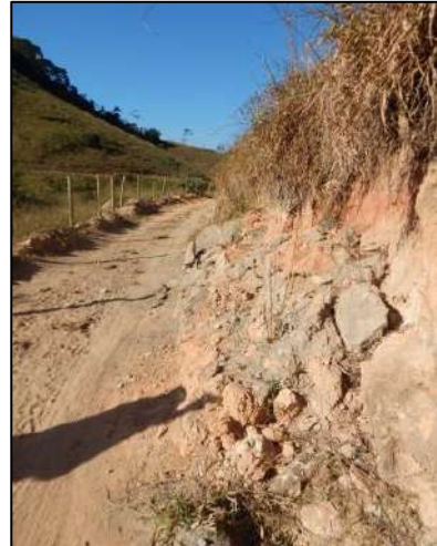
Foto 93: Desmoronamento do talude da estrada
