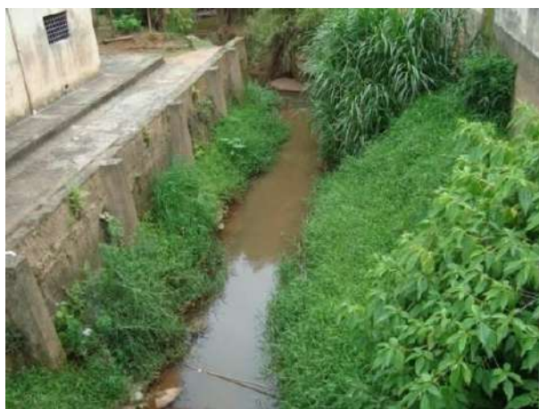
Figura 22 - Ponto de lançamento de esgoto "in natura" da sede municipal de Aiuruoca (córrego da Campina).
