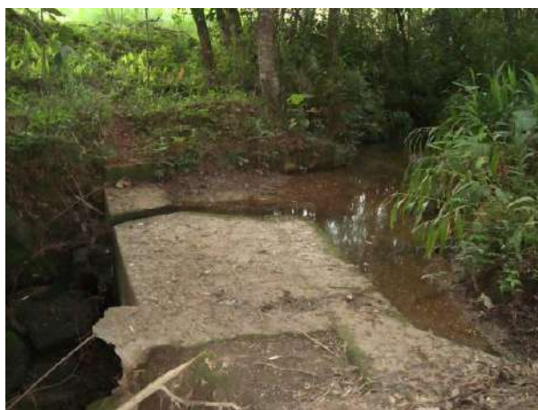
Figura 21 - Ponto de captação para o abastecimento público da sede municipal de Aiuruoca.
