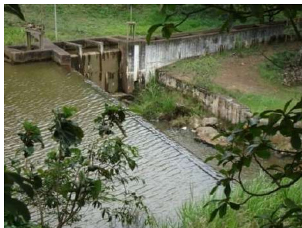
Figura 31 - Barramento PCH inoperante.
