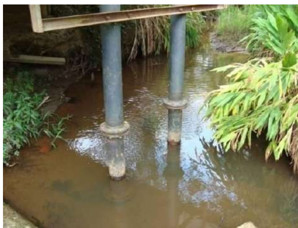
Figura 58 - Ponto de captação para abastecimento público da sede municipal de Ingai.
