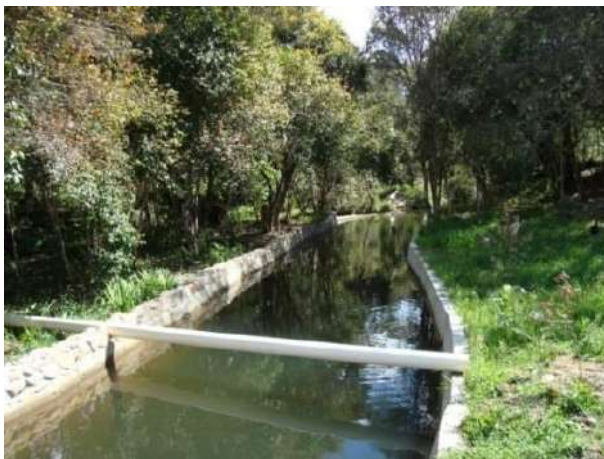
Figura 8 - Captação para abastecimento de tanques de piscicultura (trutas), no córrego do Meio.
