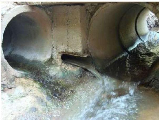
Figura 59 - Ponto de lançamento de efluentes domésticos e industriais da sede municipal de Ingai.
