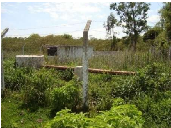
Figura 44 - Estação de tratamento de esgoto da sede municipal de Minduri.
