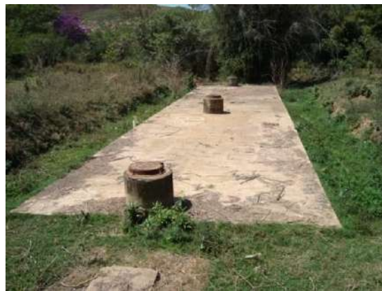
Figura 104 - Estação de tratamento de esgoto da sede municipal de Madre de Deus de Minas.
