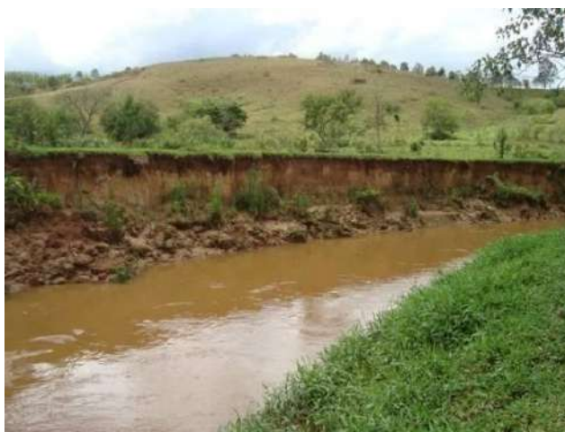
Figura 36 - Ponto de lançamento de esgoto da sede municipal de Andrelândia, em destaque a quase total inexistência de vegetação ciliar no local, o que vem a ser uma das principais causas dos desbarrancamentos das margens e conseqüentemente o assoreamento do curso d'água.
