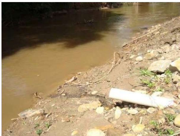
Figura 3 - Ponto de lançamento de esgoto bruto da sede municipal de Alagoa.
