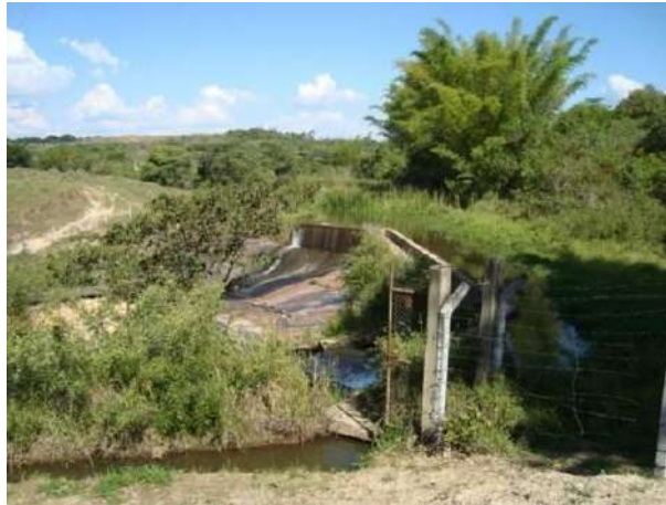
Figura 127 - Ponto de captação do distrito de Macuco de Minas (Itumirim).
