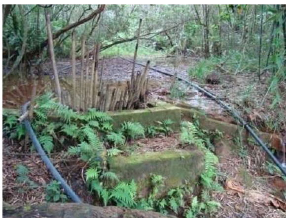
Figura 33 - Ponto de captação da comunidade rural Mato Virgem (Liberdade).
