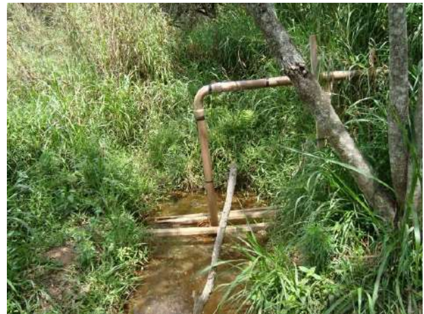
Figura 29 - Captação para o abastecimento industrial.
