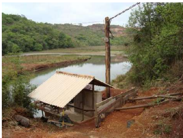
Figura 140 - Captação para o abastecimento industrial.
